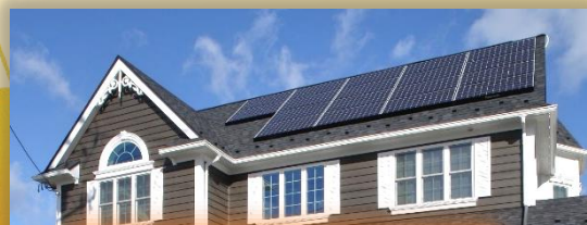
太陽光パネル 4.15kw
